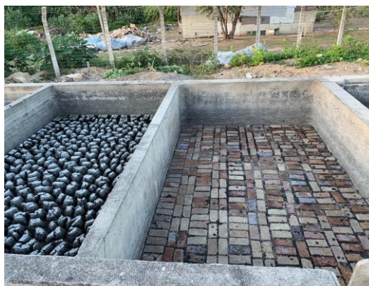
Estação de tratamento de água da Lavanderia Zigurat
